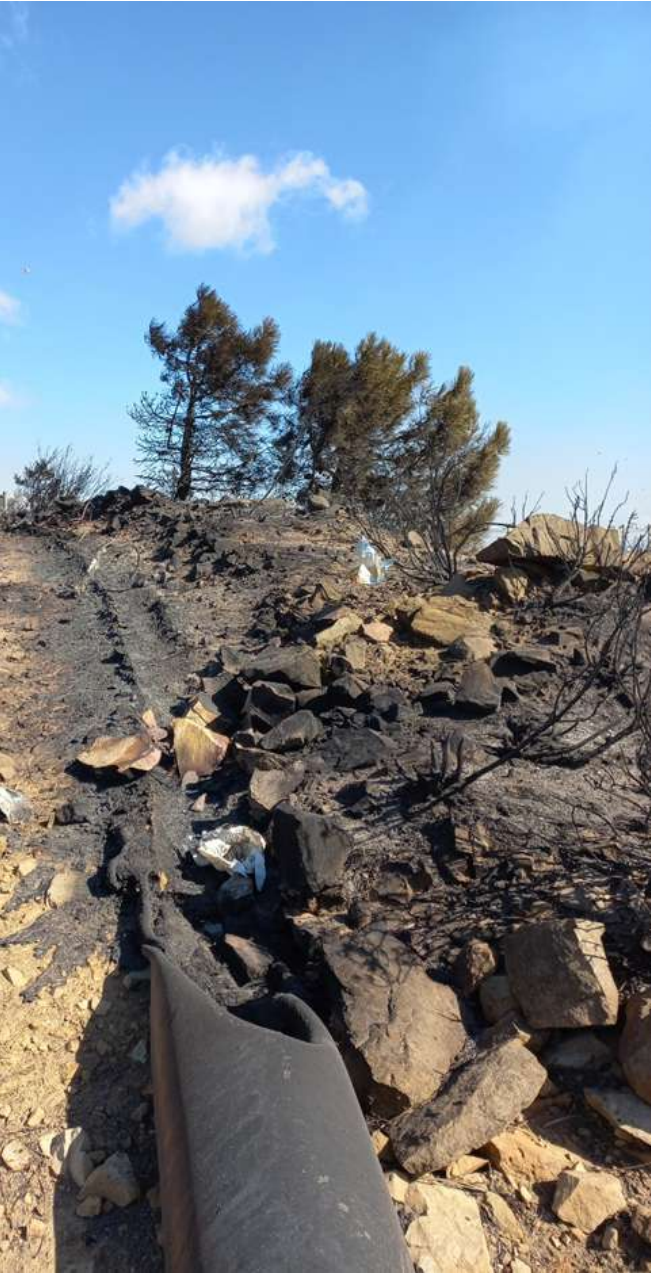
Détérioration du réseau de captage du biogaz par les flammes
